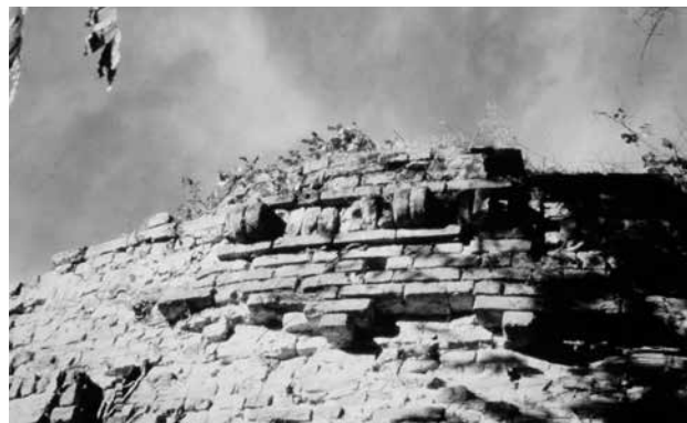
↳ Torre del Castello, sfaldamento del rivestimento e sgretolamento dei mattoni di sostegno.
