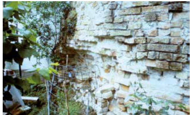
↳ Sfaldamento alla base, Torrione San Bartolomeo.
